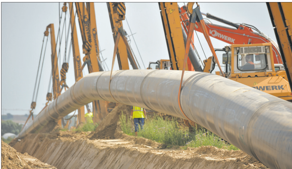
Die Süddeutsche Erdgasleitung erstreckt sich von der hessischen Landesgrenze bis nach Bayern.
